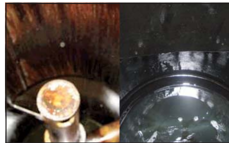
Емкость загрязненное состояние чистое состояние
