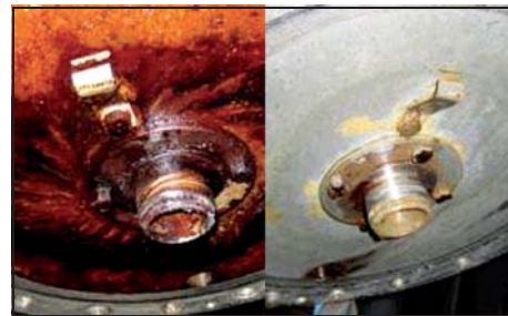
Крышка емкости загрязненное состояние чистое состояние
